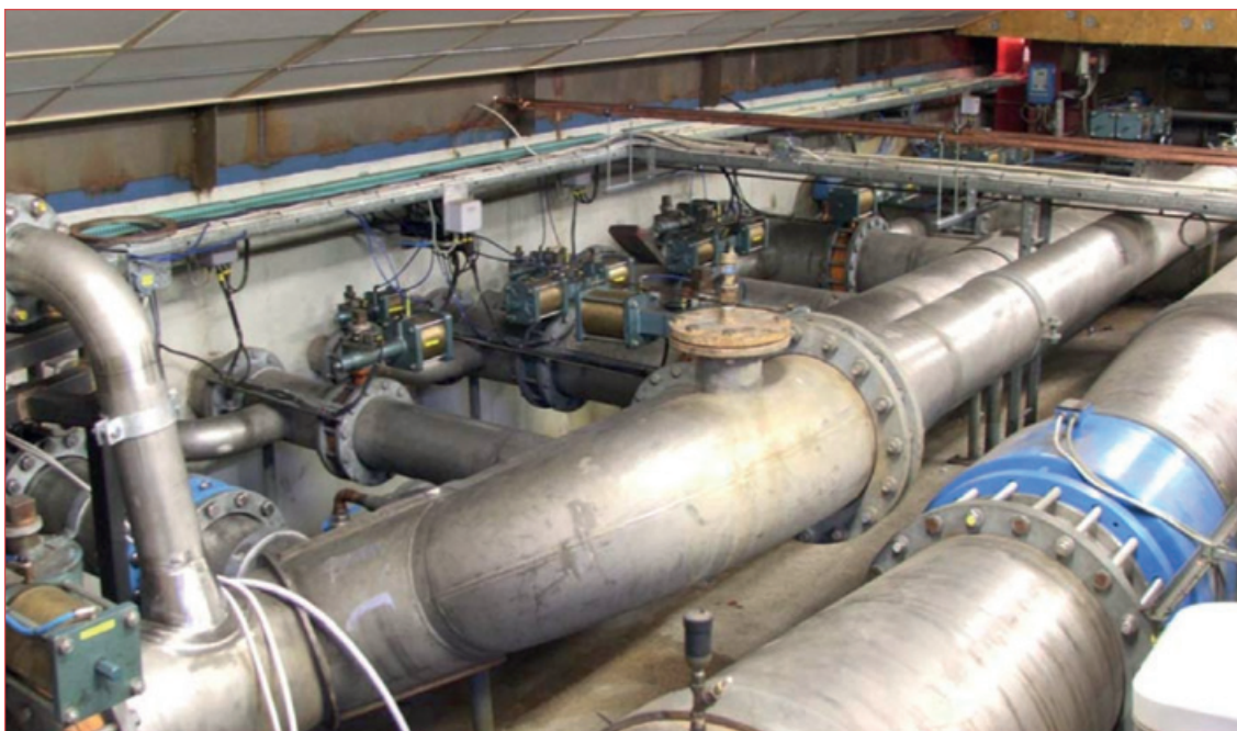
Figure 1 : photo des conduites d'un bac d'essais avec son débitmètre électromagnétique
