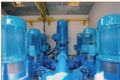
Station de pompage destinée à l'irrigation collective
